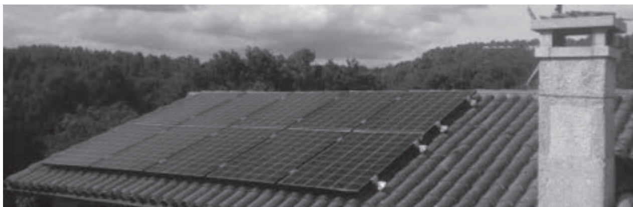
Instal·lació fotovoltaica realitzada per la cooperativa Som Confort Solar de Sabadell
