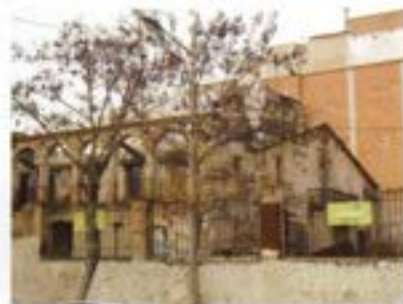
El actual estado de ruina de nuestra Masía sigue avanzando. ¿Hasta cuándo?
